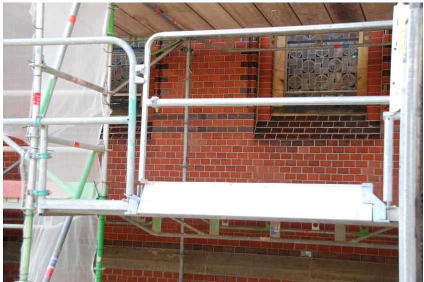
Das Foto zeigt einen Teil der erneuerten Fugen an der jetzt noch eingerüsteten Nordseite.
