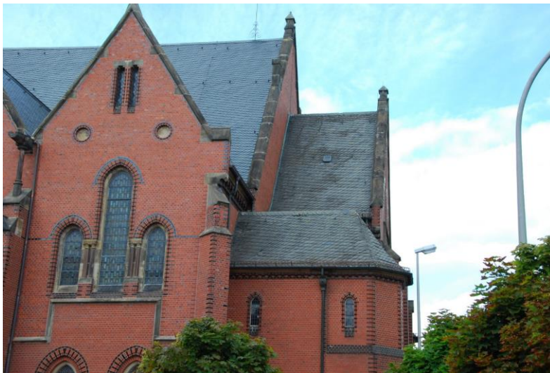
Hier deutliche zu sehen, das renovierte Dach, links und das alte Dach, rechts.
