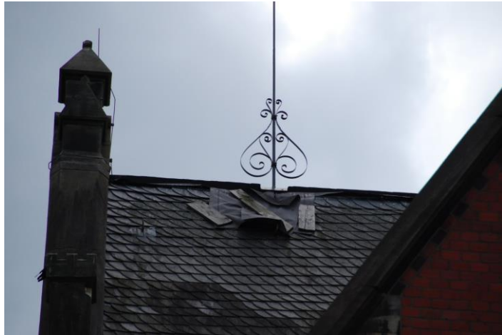
Das marode Dach der Nordseite mit prov. Abdichtungen
